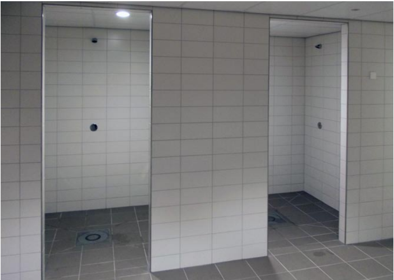
Geïnstalleerde doucheputten met WTW in het hoofdkantoor van Tennet te Arnhem
